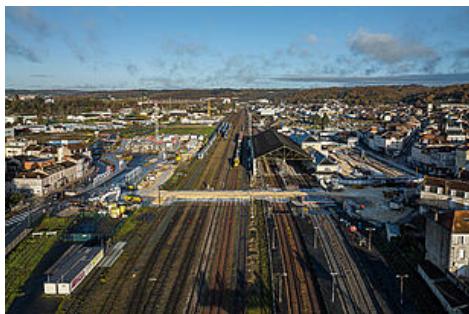
Démolition de la passerelle SNCF, gare de Périgueux - 4 et 5 décembre 2021 © Déclic & Décolle
